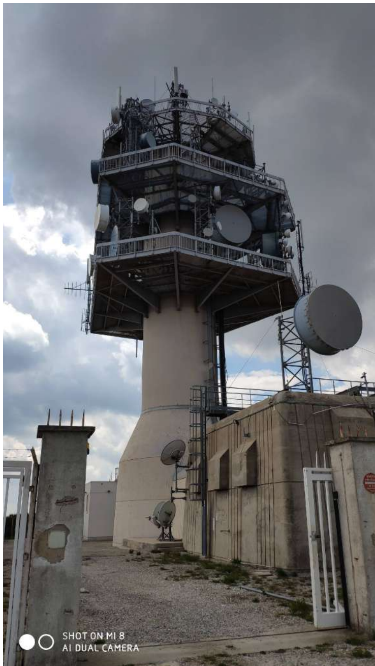
Figure 4 - Antennes de Faisceau Hertzien
